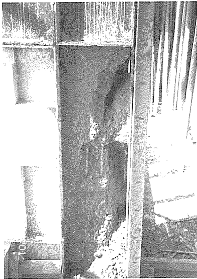
사진 2. 거푸집 존치기간 미준수에 따른 품질결함
