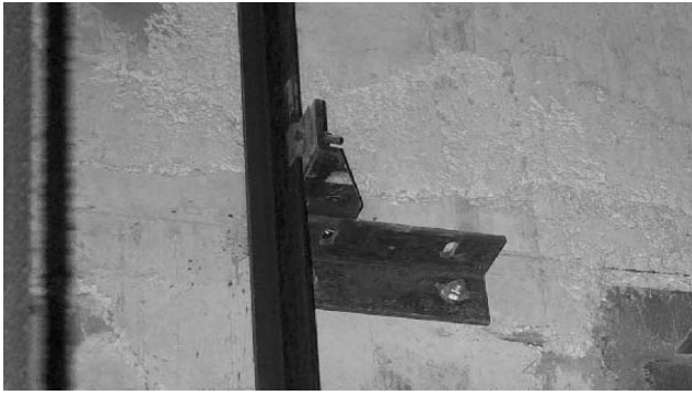
〈그림5〉 수직 RAIL과 브라켓의 탈락 2
