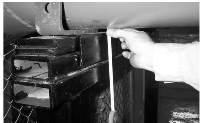
〈그림3〉 최상층 기계실 수평배관과 브라켓이 탈락한 모습
