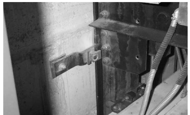
〈그림4〉 수직 RAIL과 브라켓의 탈락 1
