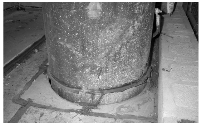
〈그림2〉 수직 배관이 슬래브 위로 솟아 오른 모습
