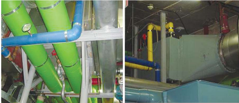
[그림 10] 연도에 설치된 폐열회수기
