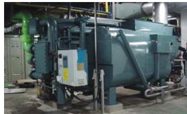
[그림 8] 개선後 냉난방용으로 설치된 흡수식냉온수기
