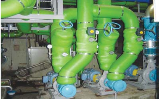
[그림 14] 개선後 설치된 신규펌프
