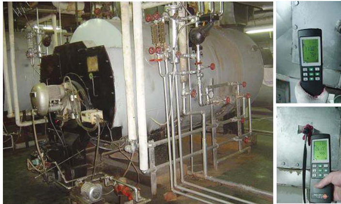
[그림 4] 기존 보일러 전경과 고부하 및 저부하 시 배기가스 온도 측정
