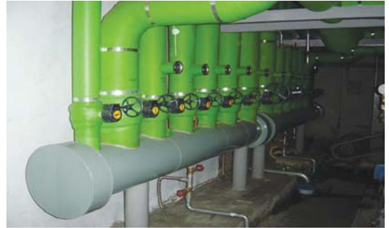
[그림 15] 개선後 설치된 신규헤더
