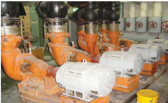
[그림 12] 개선前 기존의 노후 펌프
