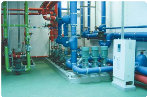
▶ 부스터펌프와 열병합발전기가 설치된 기계실 내부
