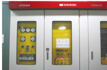
▲ 4개의 단지로 전기를 공급하는 22.9KV.MOF.PANEL
