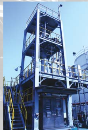
▲ 울산화학 HFCs 폐가스소각로
