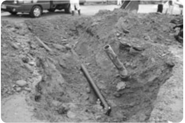
배수관로 파손 현장
