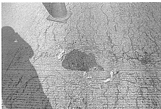
〈그림-2〉 ASR 파손 현상
