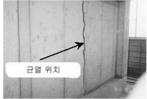
벽 부재 입면과 균열 상황
