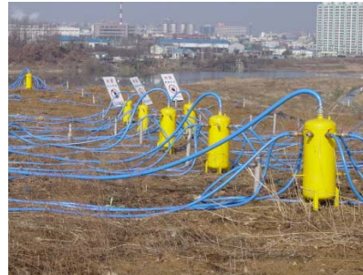
(h) 설치 전경
