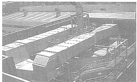
그림 6. 도심지 발전소 열공급 보일러 덕트의 모습
