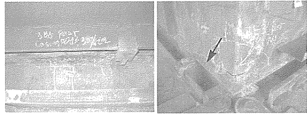
[그림 7] B/Stay 주변 Casing 균열 [그림 8] Corner 부 균열
