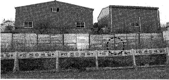
<사진 5> 눈가리기식의 방음벽 설치후 공사가 재진행되고 있다. 방음벽은 단지 언덕을 가리고 있을 뿐이다(점선 안은 농장주의 공사현장 출입을 금지하는 내용의 팻말)
