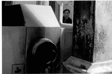
■ 사진 1. 배기구와 덕트 소손부분·연결부분은 녹아서 없어짐
