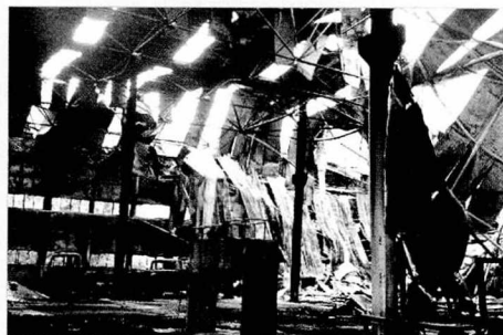
[사진 4] 건물 지붕 및 외벽 소손 모습
