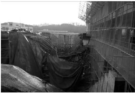
<사진5> 거푸집 슬래브 붕괴 현장
