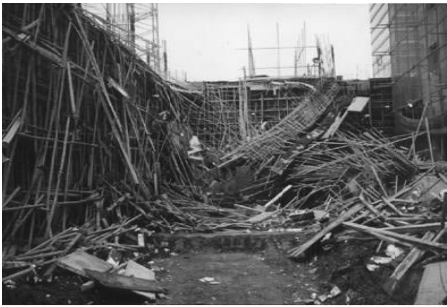
〈사진1〉 거푸집 붕괴사고 현장
