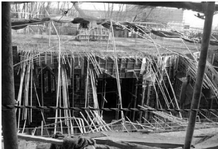
<사진6> 거푸집 슬래브 붕괴 현장
