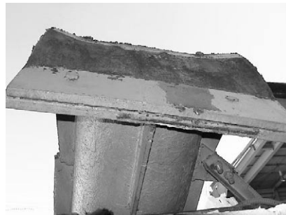
〈사진2〉 파괴된 주트러스 지지기둥 베이스플레이트부위
