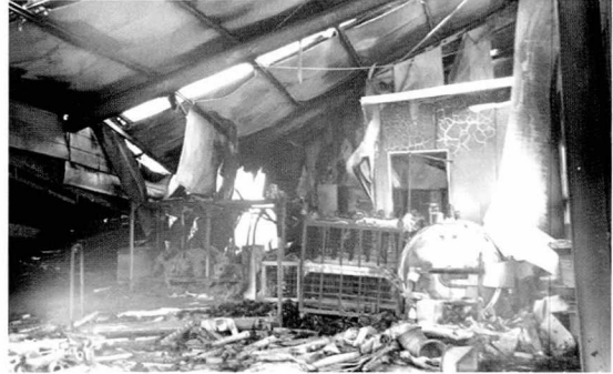
[사진 4] 소실된 물품과 기계류가 어지럽게 널려 있는 공장 내부 모습
