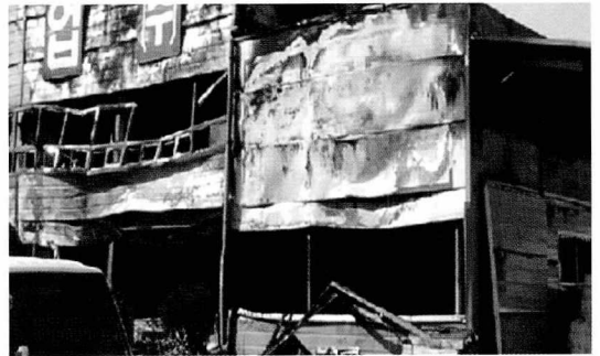
[사진 1] 화재건물 등측면 외벽 훼손상태
