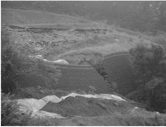
그림 6. 붕괴된 보강토옹벽 전경 1
