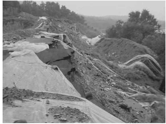
그림 7. 붕괴된 보강토옹벽 전경 2
