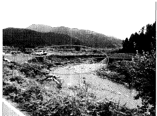
그림 15. 반월천 하류부 신설 23번국도 인접 제방파손 현황
