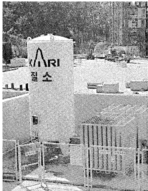
그림 3. 액체질소 저장탱크 및 기화기
