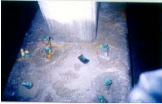
Fig. 13 다발관 그라우팅 실시 전의 누수 상태
