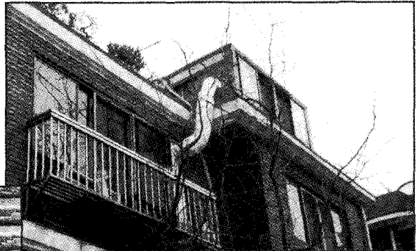
△ 거실내의 공기를 알미늄 연통을 이용하여 옥상 온실로 붙어 넣어 당시 설치했던 보일러를 폐기했다. 전기료는 거의 미미한 정도(천원미만)
