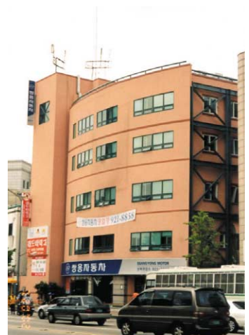
사진 1 붕괴되지 않은 전면 부분 내부 철골 바닥과 외벽 일부 붕괴
