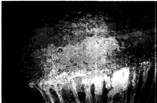
(f) 하부구조물 균열
