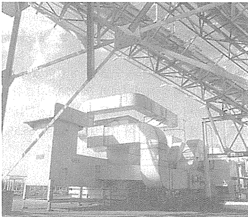
동경공장 흡착촉매 탈취장치
