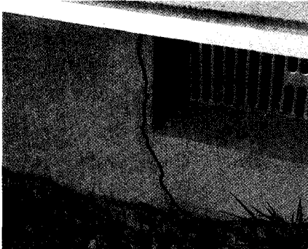
기초에 생긴 커다란 금. 바닥밀 환기구 근처는 특히 금이 생기기 쉽다.
