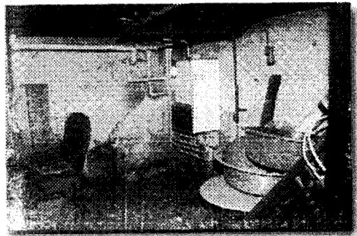
지하실에 설치된 보일러
