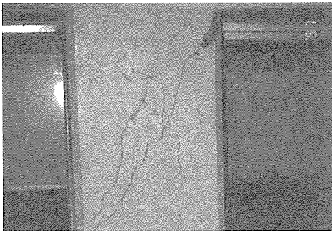
사진 1. F/10열 C 4 기둥의 사인장 균열상태
