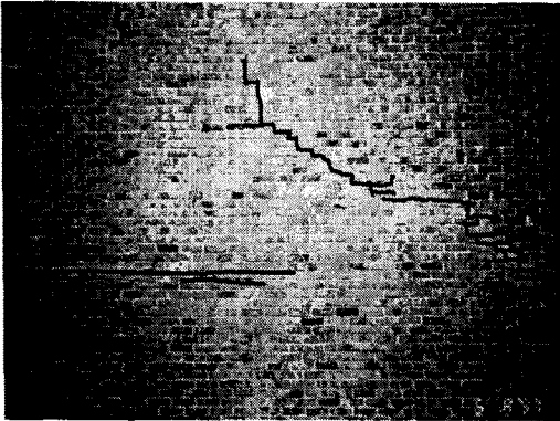
사진 2.1 집중하중에 의한 균열
