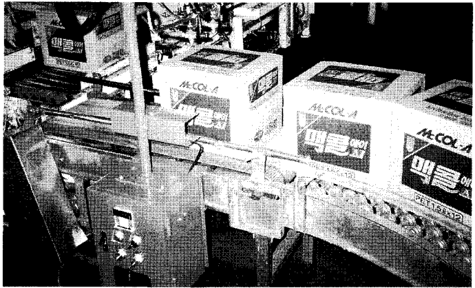
▲ 생산라인에 설치된 SLIP - STOP 자동분무 시스템
