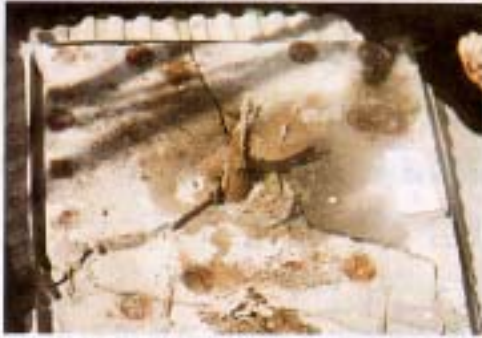
Photo 2. 균열이 심한 부분(해체중)
