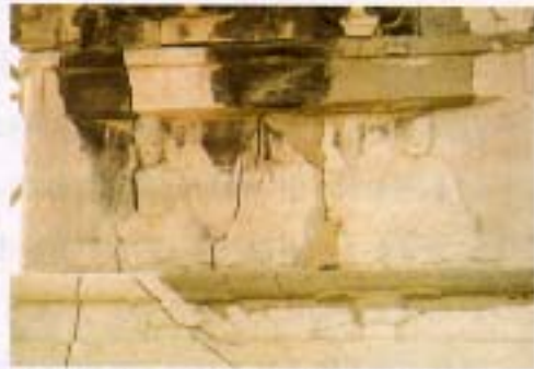
Photo 3. 균열되고 시멘트로 보강한 부분(해체중)
