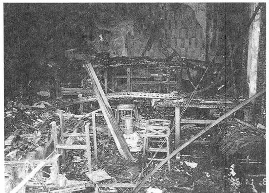
<사진 6> 1층 점포 내부 - 천정 및 벽체부분이 소손되었으며 석유난로가 있던 중앙바닥은 영향을 적게 받았다.
