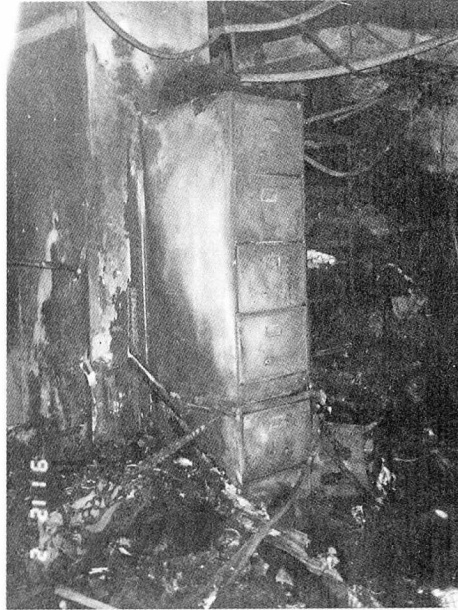
사진 왼쪽, 콘크리트 기둥에 붙여세워진 철제 서류파일이 사진을 찍은 방향으로부터 진행되어진 화열을 받아 변색되었음을 볼 수 있다.
