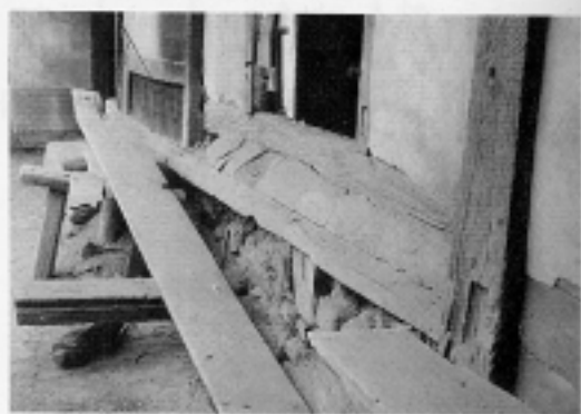
Photo 6. 안방의 토머름과 빗마루의 파손 상태(김주태 가옥)
