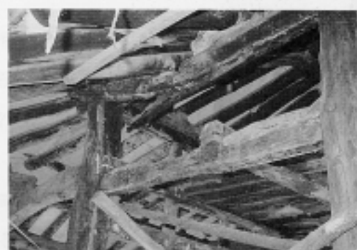
Photo 12. 남측방 동측면 주심도리의 부식 절단 상태(심검당)
