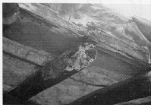
Photo 3. 후면 연목의 부식 상태(김주태 가옥)
