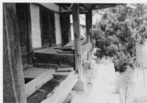
Photo 8. 사랑채 빗마루의 파손 상태 (김주태 가옥)
