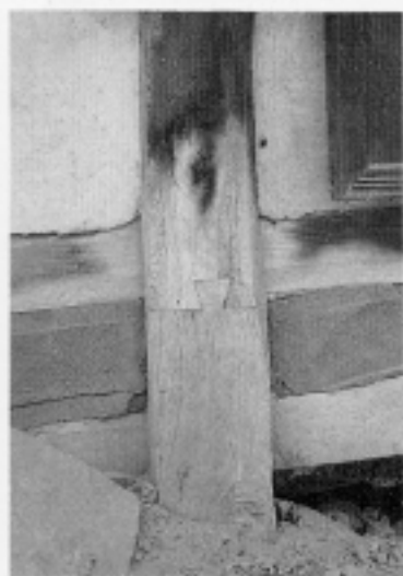
Photo 5. 기둥의 타목재 이음 상태(김주태 가옥)
