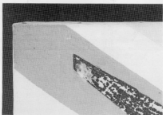
사진 7. 그라운드층까지 도달한 格子型 균열과 박락.
