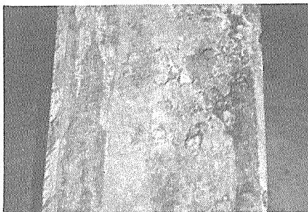
〈그림 3〉 손상된 콘크리트 기둥
