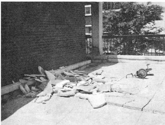
▲ 위험물 지하탱크 저장소가 있던 실 상부옥상의 파손된 모습.
