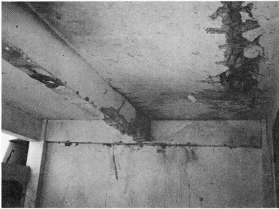
▲ 위험물 지하탱크 저장소가 있던 실의 벽체와 천정의 파손 된 모습.
