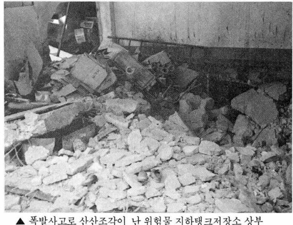
▲ 폭발사고로 산산조각이 난 위험물 지하탱크저장소 상부 (가운데가 벙커C유 저장탱크, 좌단이 경유 저장탱크임).
