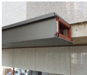
(b) 속빈구조에 의한 우수(雨水)소음
