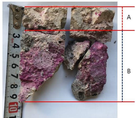
그림 2. 중성화 깊이 측정방법을 이용한 화재 깊이 측정
