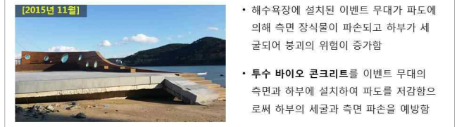
[이벤트 무대의 측면이 파손되고 하부가 세굴됨], [투수 바이오 콘크리트 설치 후 세굴이 사라짐]
