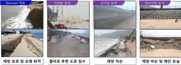
제방 보호 및 모래 퇴적, 철파로 후연 도로 침수, 제방 파손, 제방 파손 및 해안 유실
