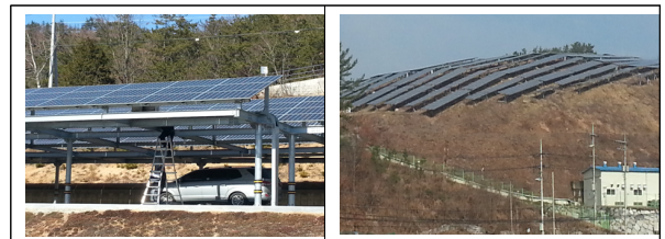
그림 2. 점검을 하기 위한 위험성 및 접근이 어려운 장소에 설치된 태양광 발전소
