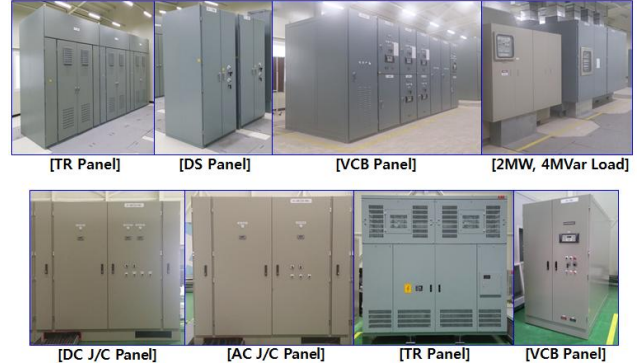
그림 5. 계통연계설비, 부하장치, Junction Panel의 모습
