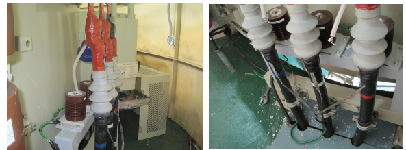
<그림 7> 인출 CV케이블 단자부 및 쉴드접지 분리 광경
