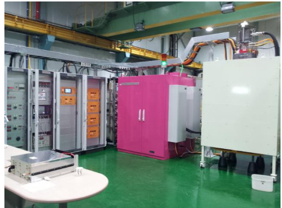
〈그림 5〉 인버터형 고정밀 고전압 전원장치 시험 설비
