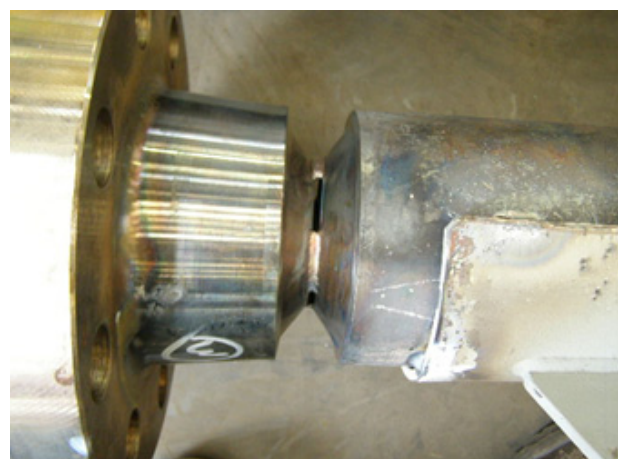
Fig. 1 고압 배관 용접 부재 사진
