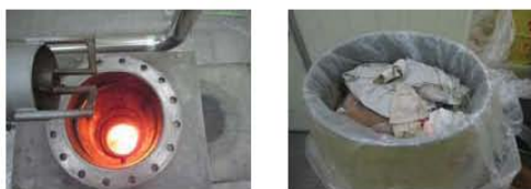
Fig. 3. 소각로 및 가연성폐기물 드럼 실제.
