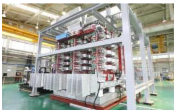
그림 1 ITER 초전도자석 전원장치
