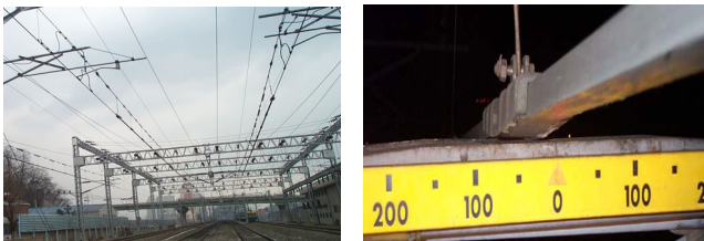
〈그림 1〉 기존 FRP계 절연구분장치 설치사진 및 절연재 마모 사진
