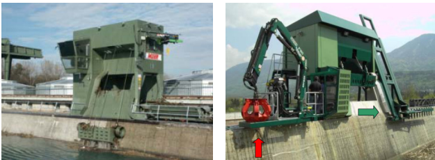
<그림 3> 제진설비 설치 사진
